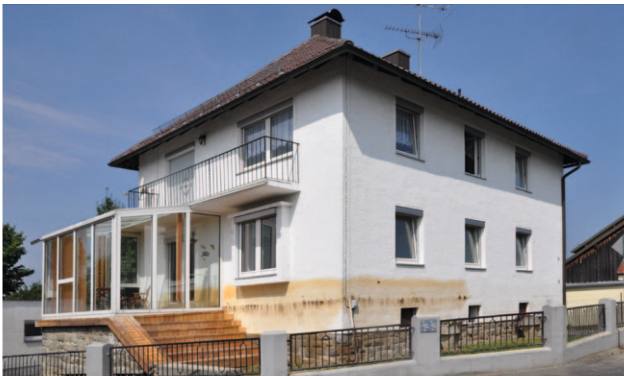
Mit Heizöl belastetes Wärmedämm-Verbundsystem eines Wohnhauses
