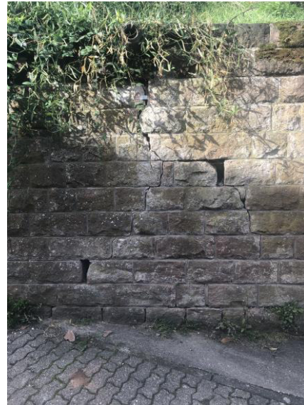
Bild 2: Riss rechts am 15.10.2021
