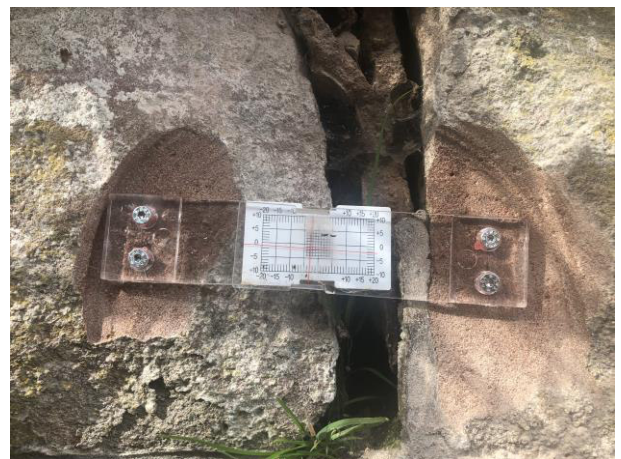
Bild 6: Detail Riss rechts am 25.10.2021
