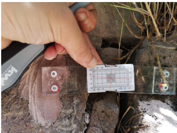
Bild 3: Detail riss links am 07.09.2021
