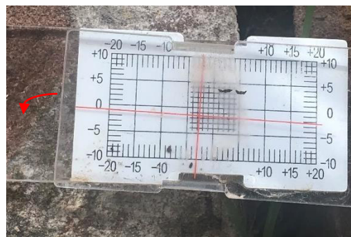
Bild 4: Riss rechts am 15.10.2021
