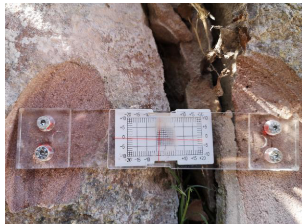
Bild 4: Detail Riss rechts am 07.09.2021
