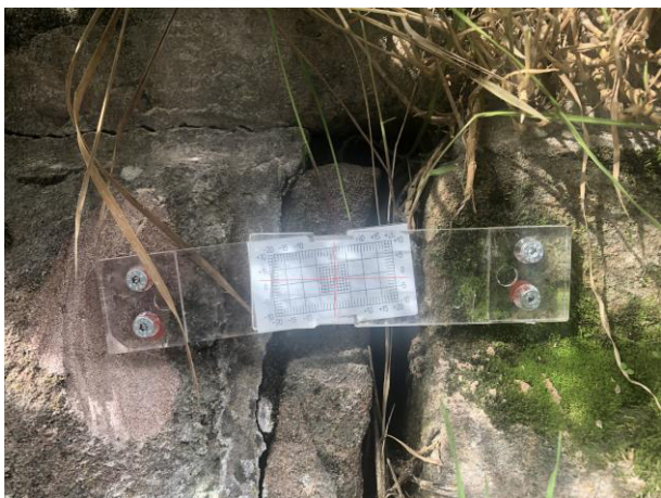
Bild 5: Detail Riss links am 25.10.2021
