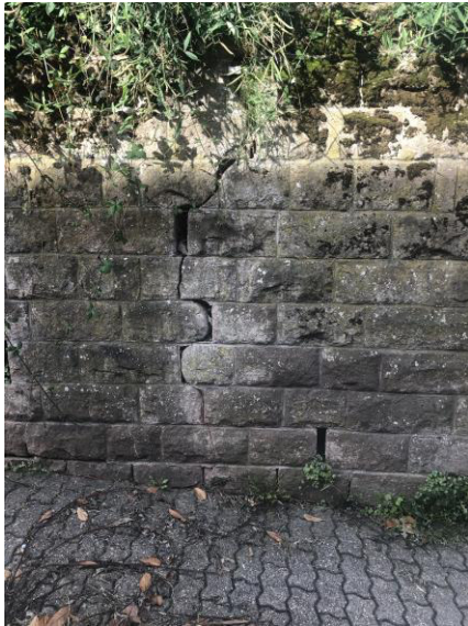
Bild 1: Riss links am 25.10.2021
