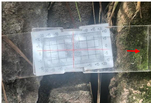
Bild 2: Riss links am 15.10.2021
