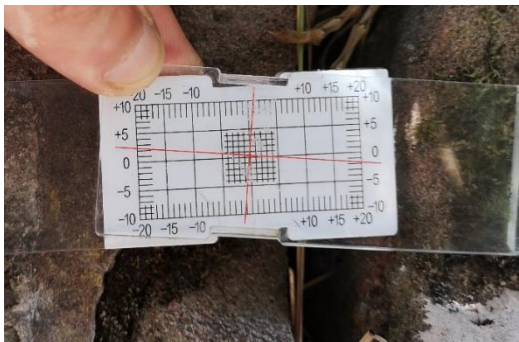
Bild 1: Riss links am 07.09.2021
